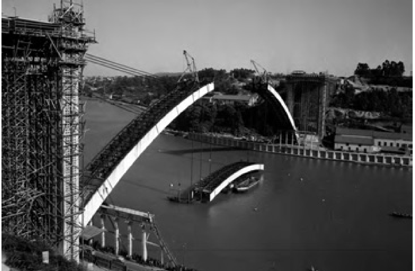
Fig. 276 Porto e Vila Nova de Gaia. A Ponte da Arrábida - marco da engenharia portuguesa da época - na véspera da colocação do fecho do arco, 13 de Julho “Arrábida” Bridge - a landmark in the Portu- guese engineering of the time - the day before the placing of the closing of the arch, July 13th
